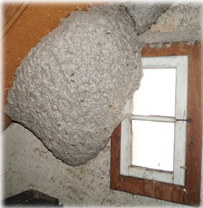
Der Ursprung dieses Nestes lag im Zwischendach des Hauses.
