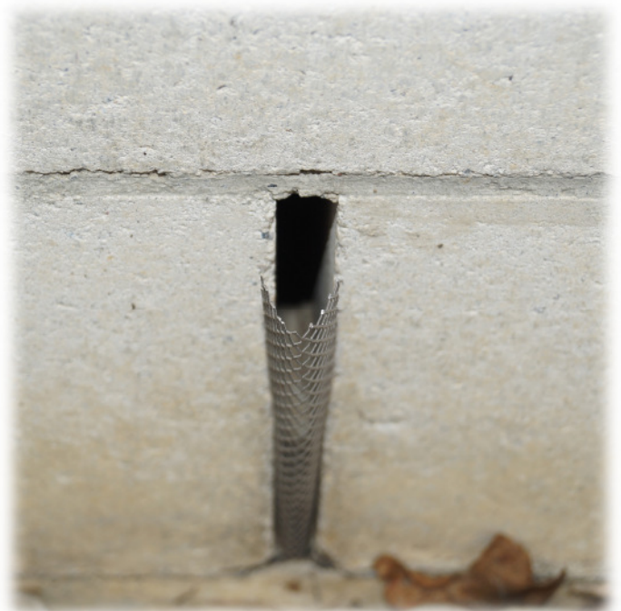
Hinterlüftung mit einem feinmaschigen Edstahlgitter vor einer erneuten Besiedelung schützen!
